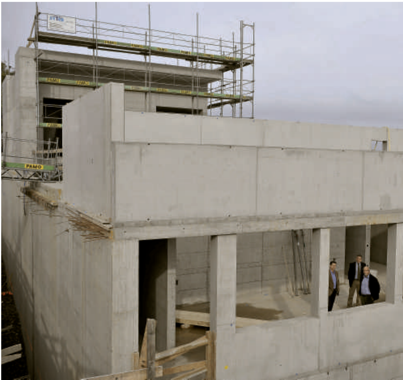
22 Meter hoch ragt der Betonbau empor. Im September 2012 soll das neue Werk am Zürichsee eröffnet werden. Foto: Manuela Matt
